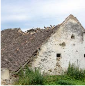
Einen Dachschaden haben.
